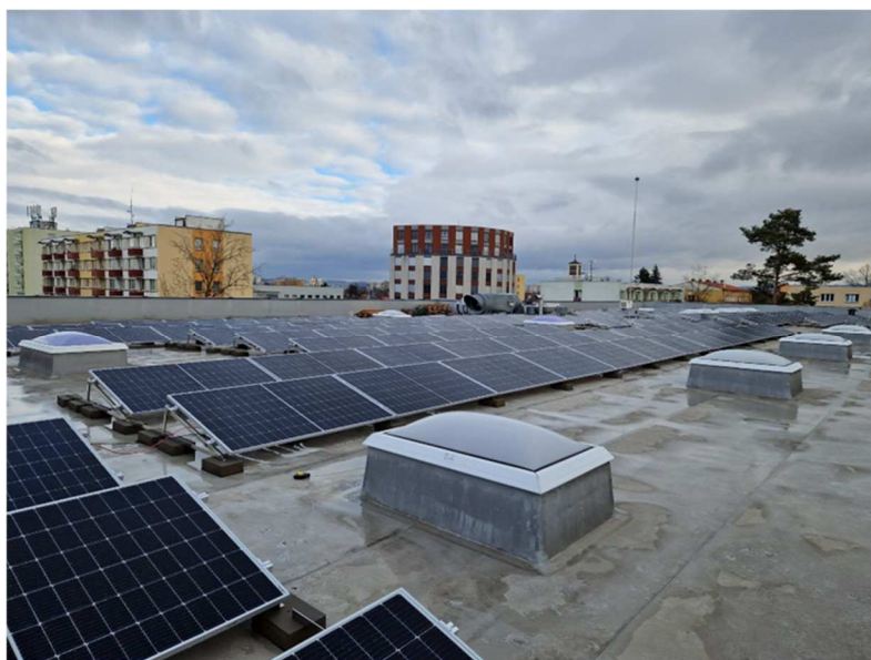
Nainstalované FV, budova Akademické knihovny JU. Foto: Projektový útvar JU
